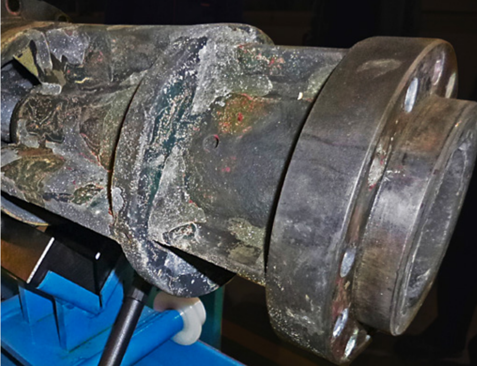
Typische Kalkablagerungen am Pumpeneinlass
